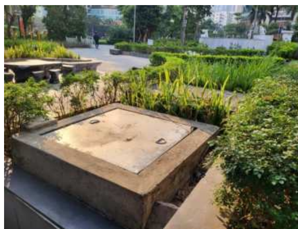
Cụm bể ASBR
