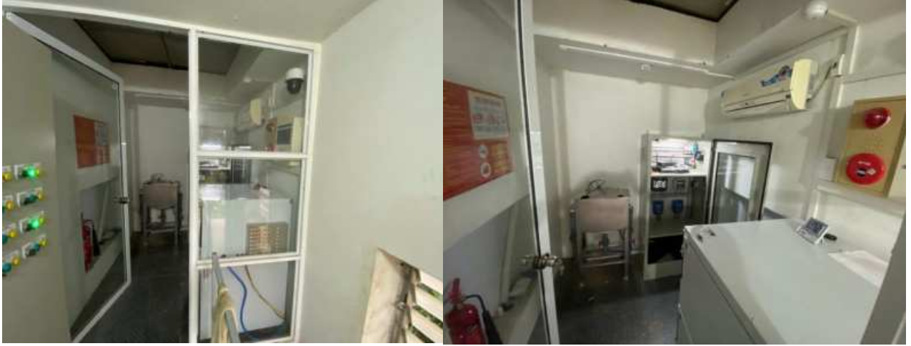
Hình 3. 9. Hình ảnh trạm quan trắc tự động đã lắp đặt
