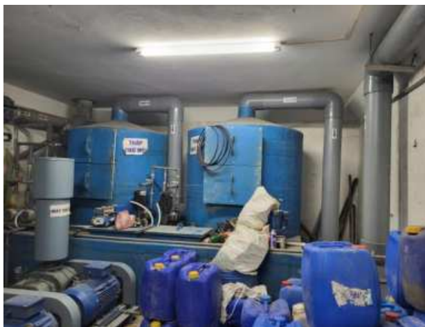
Tháp xử lý mùi
